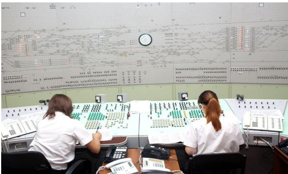
Рис. 1 Место работы дежурного по железнодорожной станции оборудовано пультом-манипулятором и выносным пультом-табло
