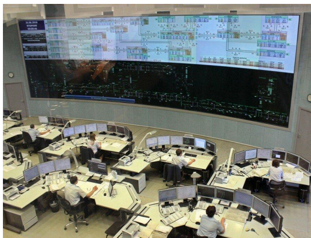
Рис. 2. Диспетчерский центр управления перевозками
