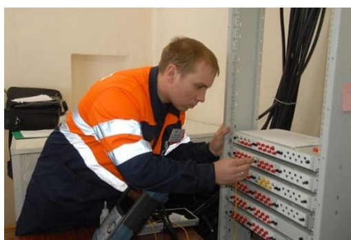
Рис. 3. Обслуживание станционного оборудования
