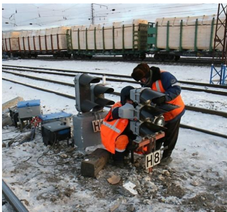
Рис. 1. Электромонтёры СЦБ обслуживают светофоры
